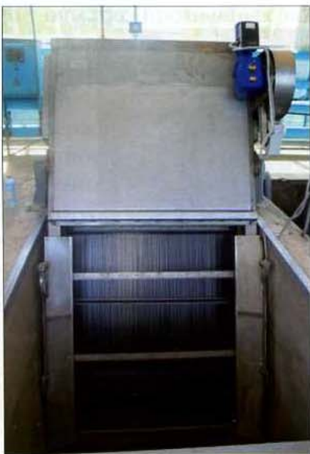
Рис. 2. Решетка РС, установленная в канале цеха механической очистки
