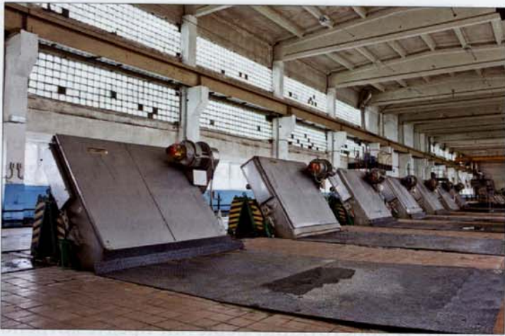
Рис. 6. Цех механической очистки с решетками РС на Курьяновских очистных сооружениях Москвы
